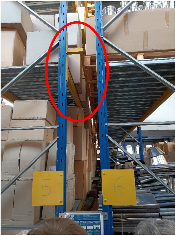
Figura 34. Barre di contenimento collocate tra due scaffalature adiacenti.
