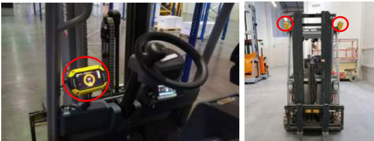
Figure 23 e 24. Sulla sinistra è evidenziato un dispositivo di allerta visiva e sonora montato a bordo di un carrello elevatore, mentre sulla destra sono indicati due sensori a radiofrequenza che rilevano gli ostacoli
